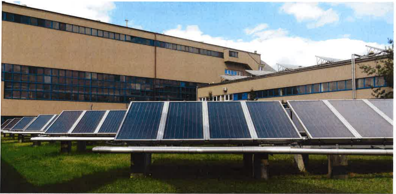
fot.1. Usytuowanie instalacji kolektorów słonecznych w ZEC Wołomin.
