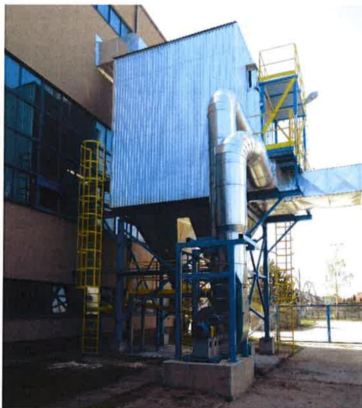
Zdj. 2 Kocioł WR-10 - Instalacja odpylania.
